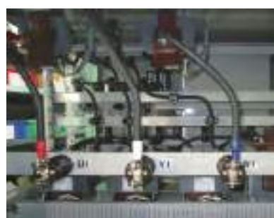
D (高圧中継端子台)
