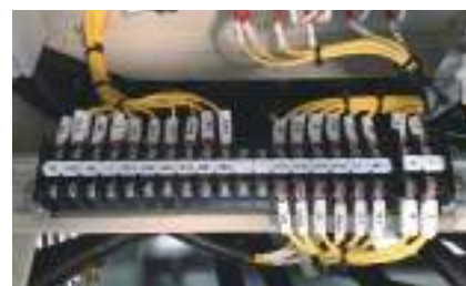
接続端子台（盤内）
