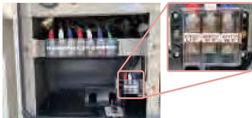
擬似負荷接続端子台
