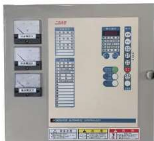
自動始動発電機盤
