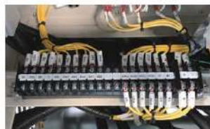
接続端子台 (盤内)
