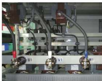
D (高圧中継端子台)
