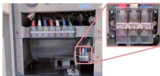
擬似負荷接続端子台
