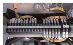
接続端子台 (盤内)
