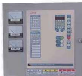
自動始動発電機盤
